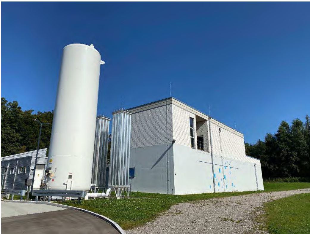
Spurenstoffelimination mit Ozontank
