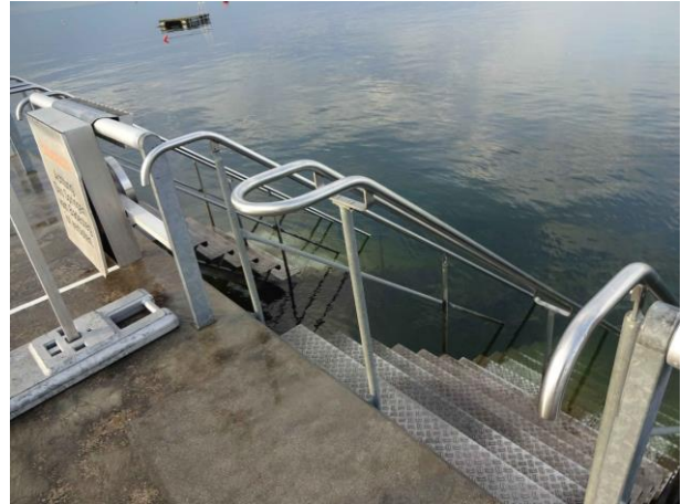
Steile Treppe am Stegkopf. Diese soll durch eine breitere und flachere Treppe ersetzt werden.
