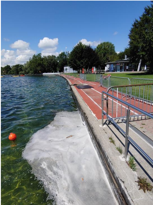
Die nördliche, marode Ufermauer bei erhöhtem Wasserstand. Der einsturzgefährdete Bereich ist abgesperrt. Rechts hinten das Kiosk.
